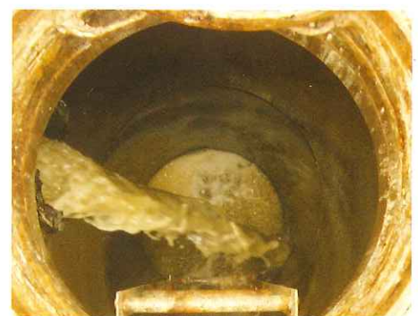
スカム排水が高所から流入するマンホール
